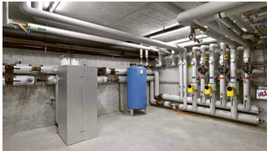
Unterstation mit Wärmetauscher (Aluschränk) und blauem Expansionsgefäß.
