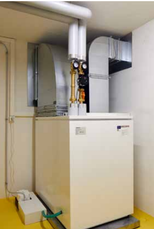
Die Wärmepumpe im alten Tankraum
