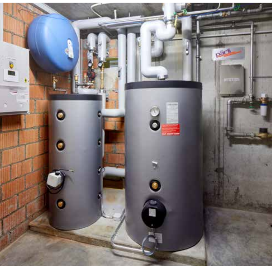
Technikraum mit Pufferspeicher (links) und Boiler
