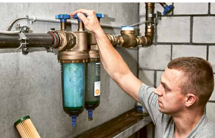
Lohnt sich: Wartung der Wasserfilter
