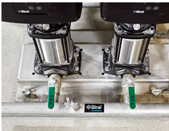
Druckerhöhungsanlage für Stockwerke 5 bis 8
