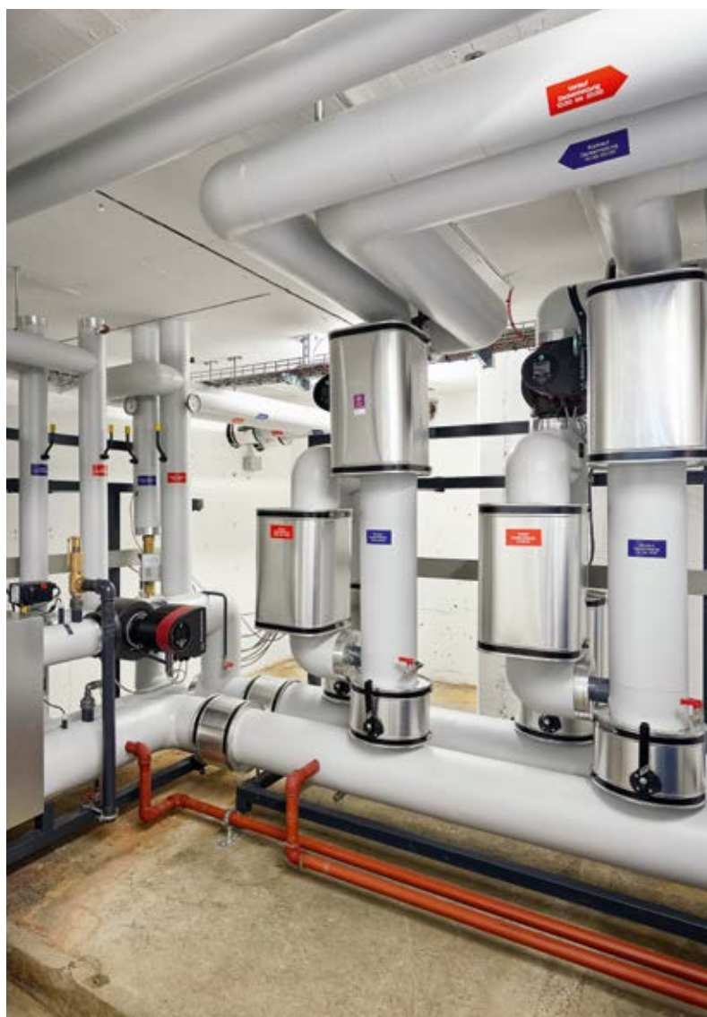
Heizungsverteiler mit zwei Heizgruppen und Fernleitungsanschluss.
