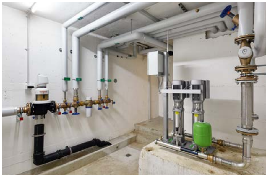
Sanitär-Kaltwasserverteilung mit Druckerhöhungsanlage.
